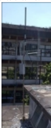
Figura 4. Nó mesh montado no topo do prédio da UFF.
